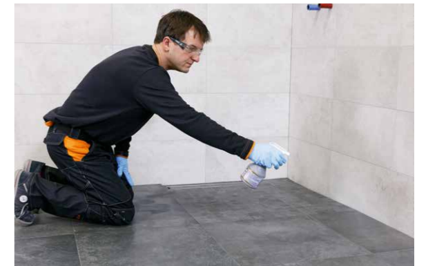
Vor dem finalen Waschgang wird nach ca. 60 Minuten PCI Durapox Finish (flüssig) auf die Fläche aufgesprüht. Alternativ kann auch PCI Durapox Finish (Konzentrat) direkt in das Waschwasser hinzugegeben werden.
