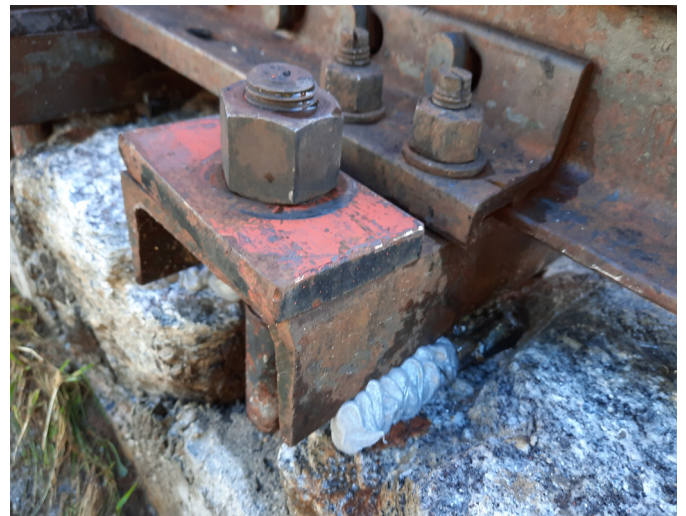
2) Die Hohlräume zwischen Bahnschwellen und Natursteinauflager wurden mit dem universellen Verankerungskleber PCI Barrafix 920 verfüllt, nachdem sie zuvor mit Stahlplatten und -keilen gesichert wurden. PCI Barrafix 920 ist auch bei tiefen Temperaturen verarbeitbar und härtet schnell aus.
